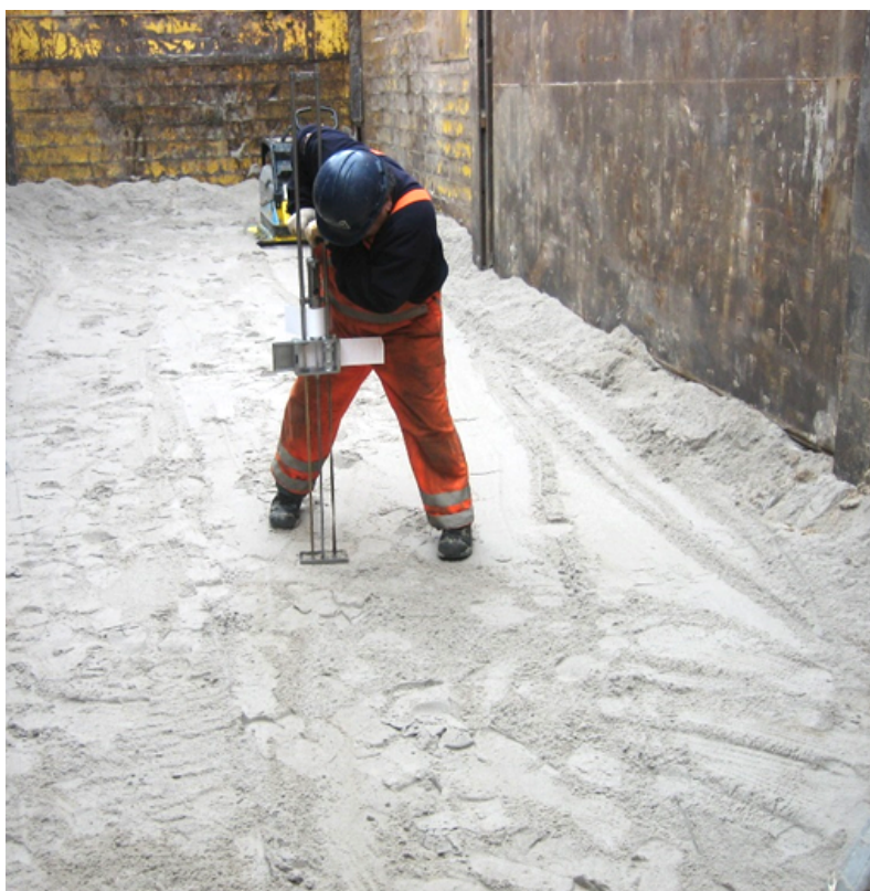
Foto: Voorbeeld van een controlemeting van de indringweerstand.
